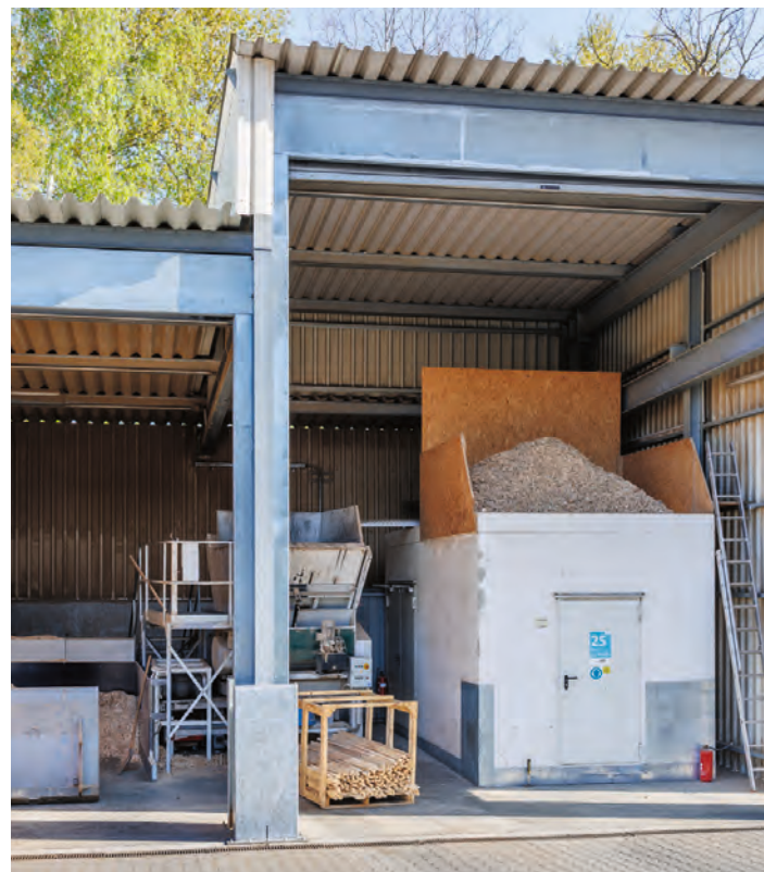
Um entstandene Holzabfälle weiterzuverarbeiten und Ressourcen zu sparen, wurde ein eigenes zu diesem Zweck entwickelter Holzpaletten-schredder angeschafft.
