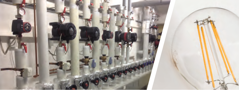
erfal produziert verstärkt nachhaltig nach neuesten Gesichtspunkten in optimierter Produktionsumgebung u. a. durch den Einsatz von LED-Technik und zentraler Gebäudeleittechnik.
